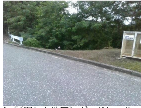
↑「(野々上地区)ガードレールが途中で切れていて、小さい子供が走ったりすると危ないと思う」
